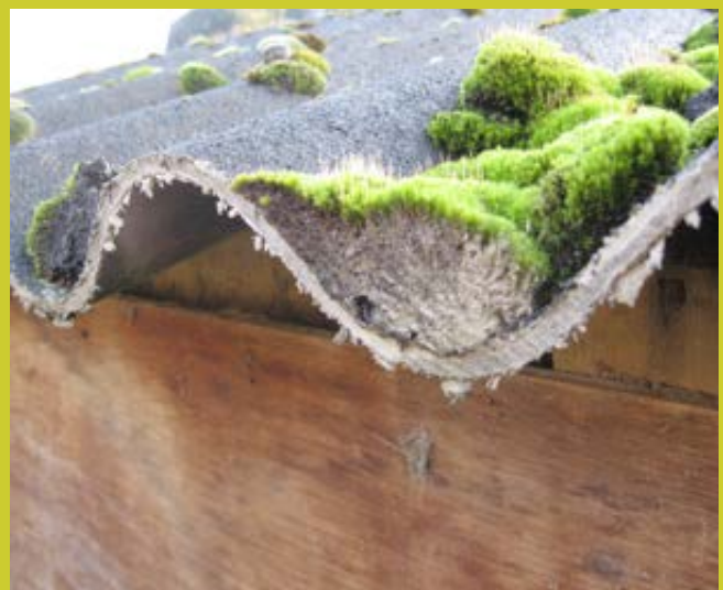
Een duidelijk bewerkte (gezaagde) golfplaat. Bewerken is verboden volgens het Productenbesluit.
