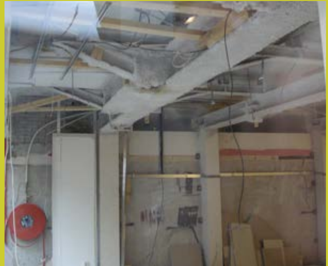
Spuitasbest op stalen balken. Sanering van spuitasbest is een hoog-risicosanering
